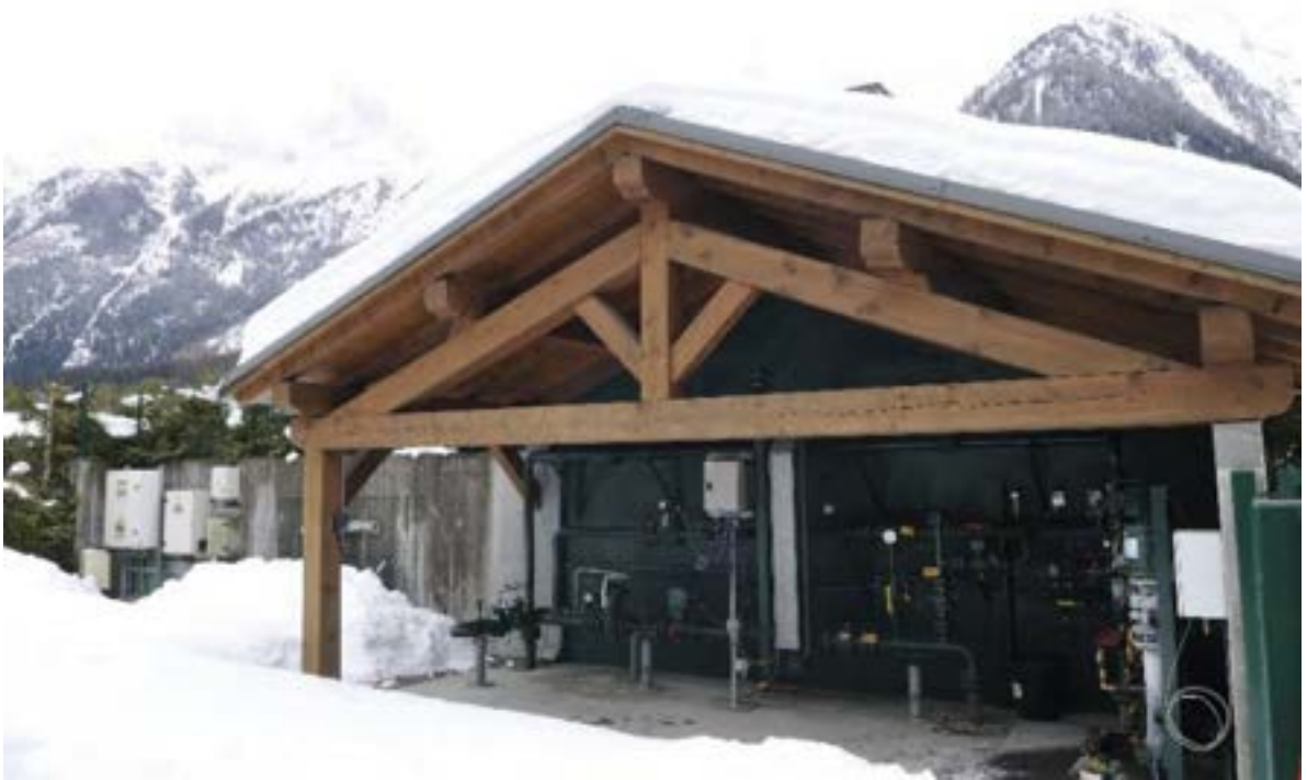
Poste de livraison à Chamonix © GRTgaz
