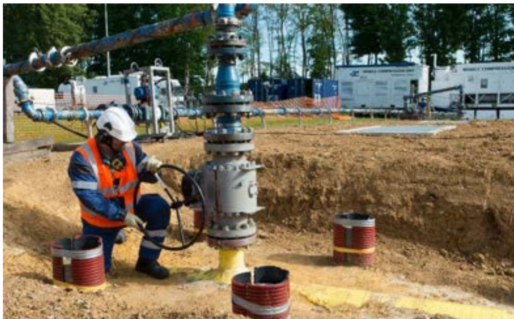
Opération de gas booster en Seine-et-Marne © GRTgaz
