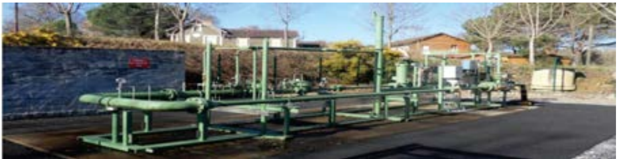
Poste de livraison © Teréga
