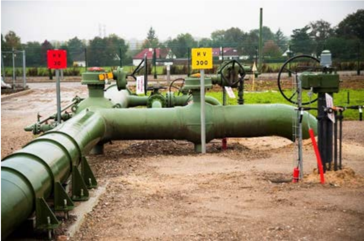
Station d'interconnexion de Férolles-Atilly (77) © GRTgaz
