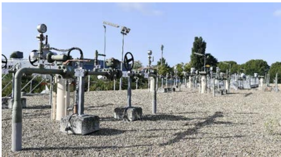
Poste de détente © GRTgaz
