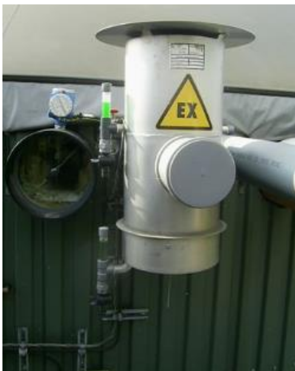
Soupape de sécurité © Bio-nrj
