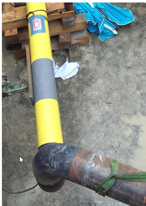
Canalisation en acier © GRDF
