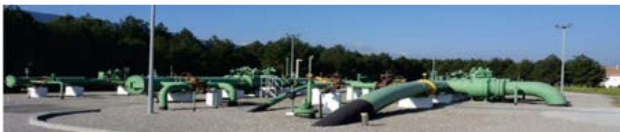
Poste de sectionnement © Teréga
